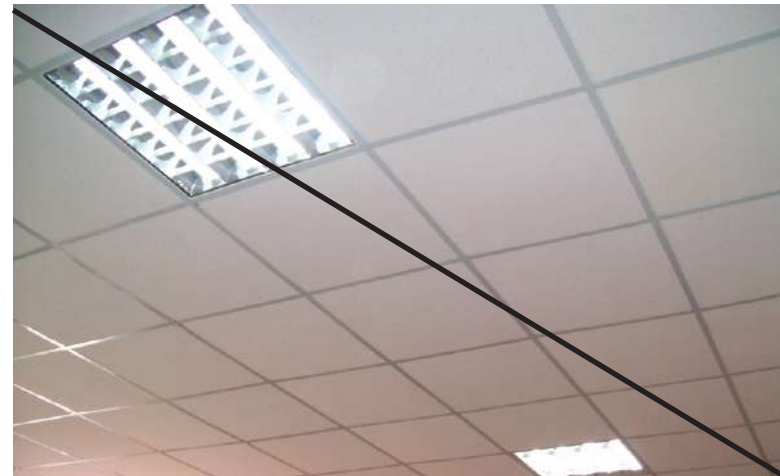
Плохо Открытые направляющие
